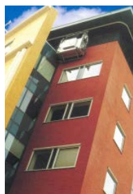
Alles wat verborgen blijft na afwerking van de gevel moet visueel beoordeeld worden en een lastbeproeving ondergaan met vollast.
